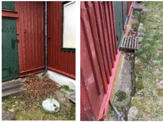
Figur 11. Regnvatten leds och ansamlas mot f.d. ladugårdsbyggnad på Langegården.
